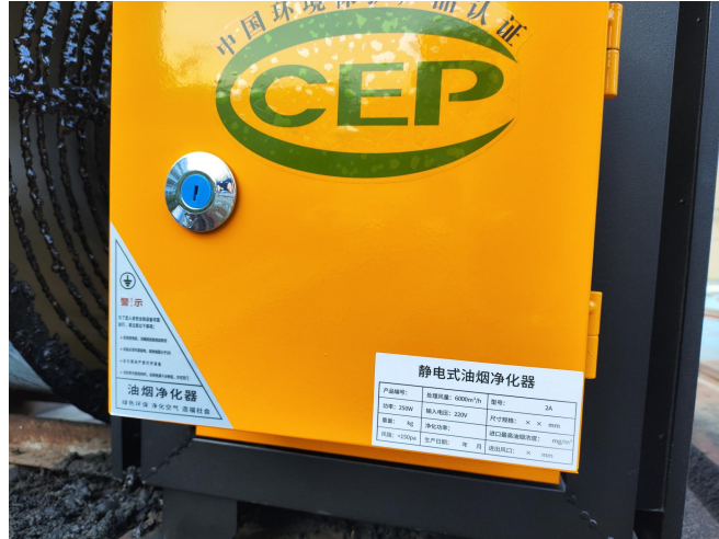
图 3-3 废气处理设施图
