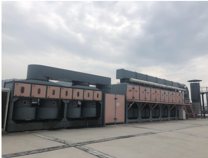
图 3-4 喷漆及烘干废气、印刷及网版清洁废气处理设施图
