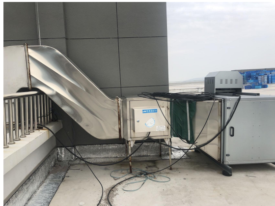
图 3-5 食堂油烟废气处理设施图
