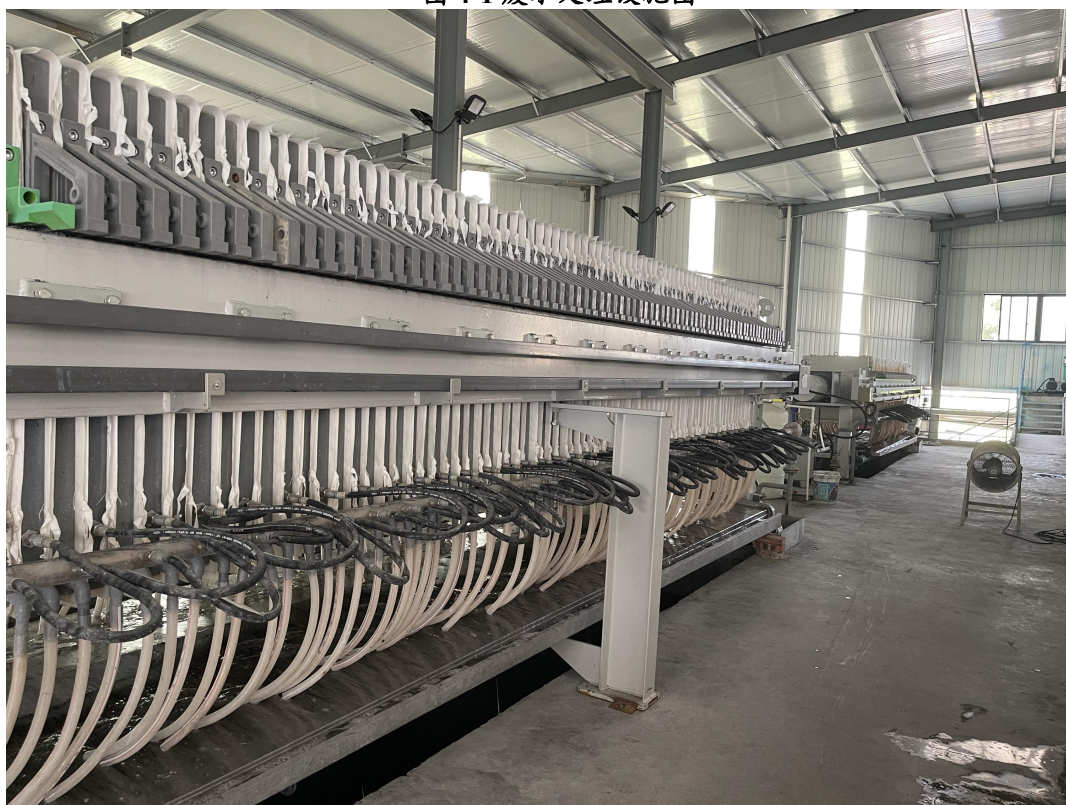
图 4-2 废水处理设施图
