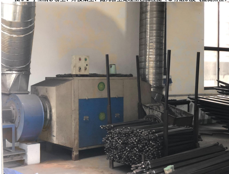
图 3-3 手工清砂粉尘、焊接烟尘处理设施图
