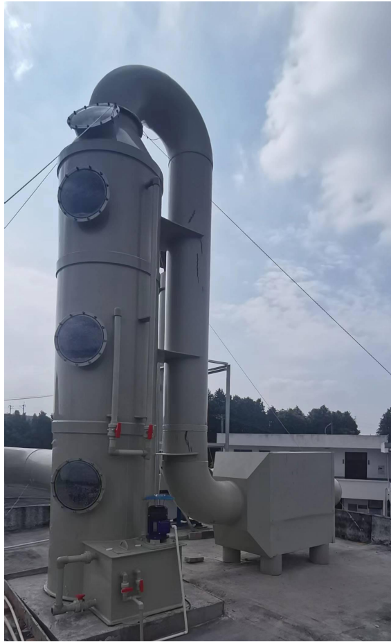
图 3-3 废气处理设施图
