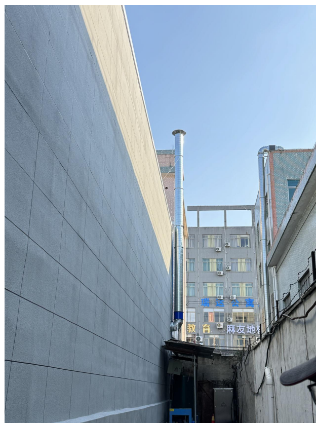
注塑废气排气筒
