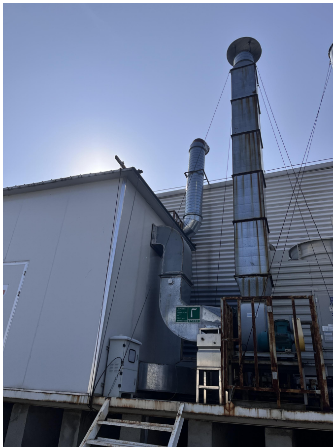
图 4-5 防雾漆油漆废气处理设施图
